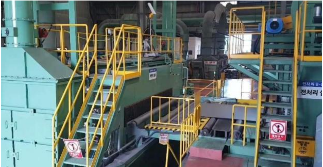
钢材预处理线（4.5m 宽，6m/min ）喷漆系统及测宽装置
