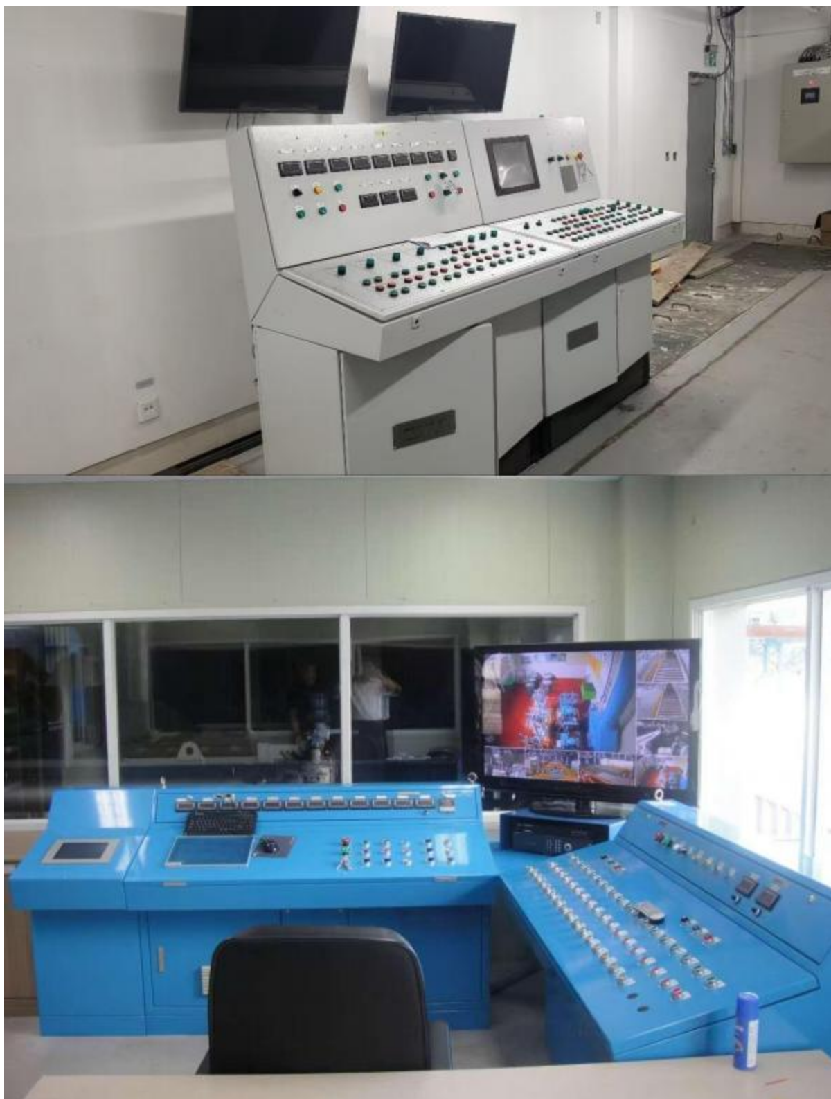
现代三湖重工钢材预处理线（4m 宽，5m/min）中央控制室
