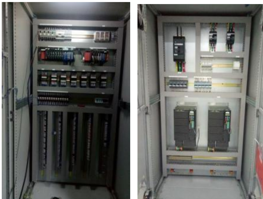
图 柜内 PLC 等原件
