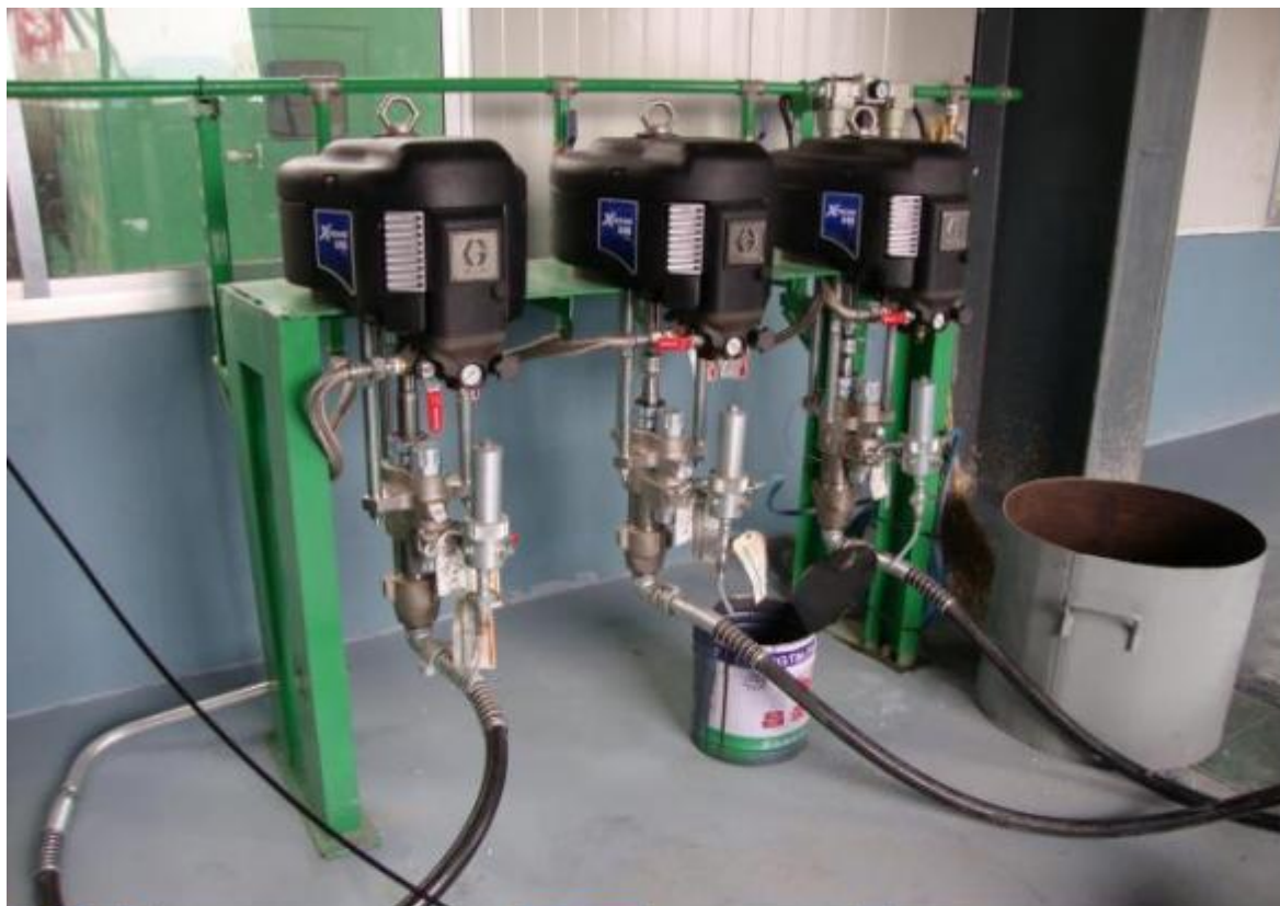
钢材预处理线（4.5m 宽，6m/min ）涂料供应系统（自动喷漆）
